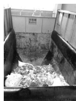
バイオマスエコセンターの分別機
